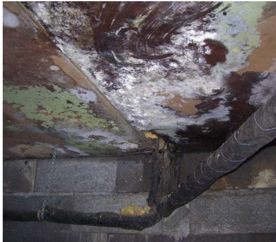
BILLEDER VENLIGST UDLÅNT AF FIRMAET BØGH & HELSTRUP I/S - BYGNINGSBIOLOGISK RÅDGIVNING
